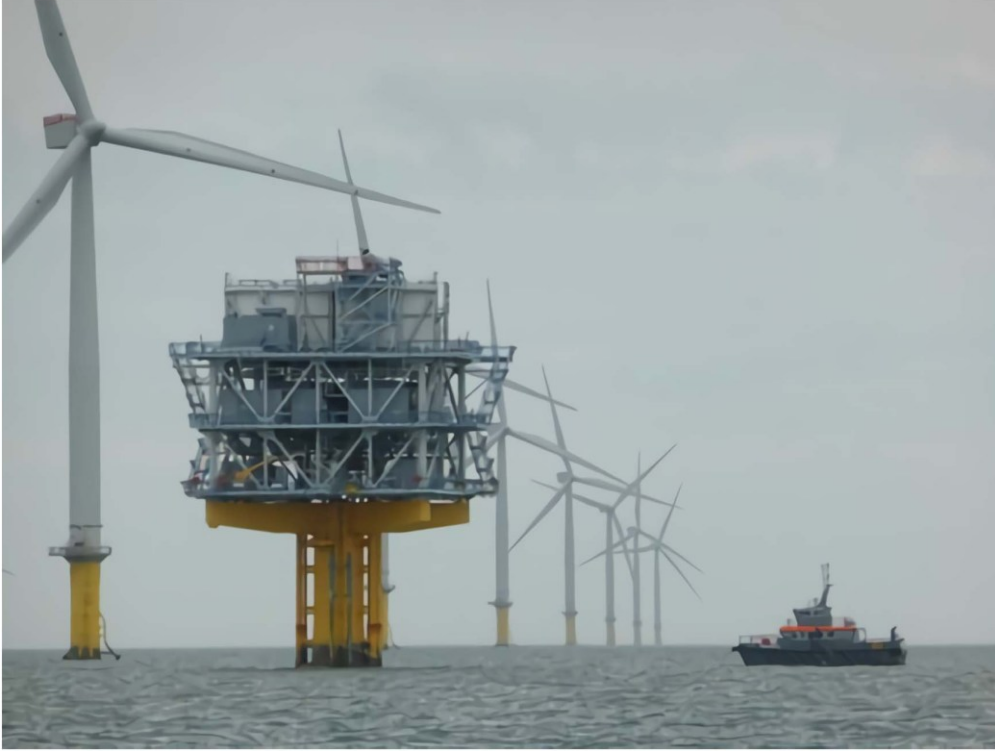
Abbildung 3.6 Beispiel für ein Offshore-Umspannwerk
