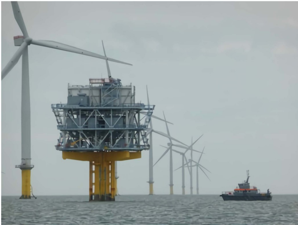
Rysunek 3.6 Przykładowa morską stacją elektroenergetyczną [źródło: https://www.flickr.com/photos/pshab/27738985766 ]
