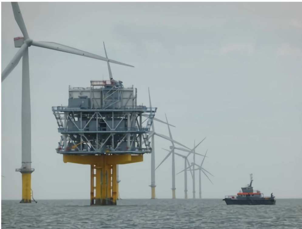
Rysunek 3.6 Przykładowa morską stacją elektroenergetyczną [źródło: https://www.flickr.com/photos/pshab/27738985766 ]
