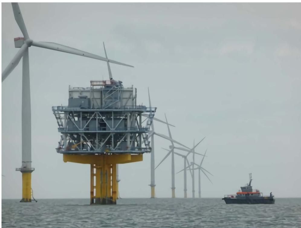
Rysunek 3.6 Przykładowa morska stacja elektroenergetyczna [źródło: https://www.flickr.com/photos/pshab/27738985766 ]
